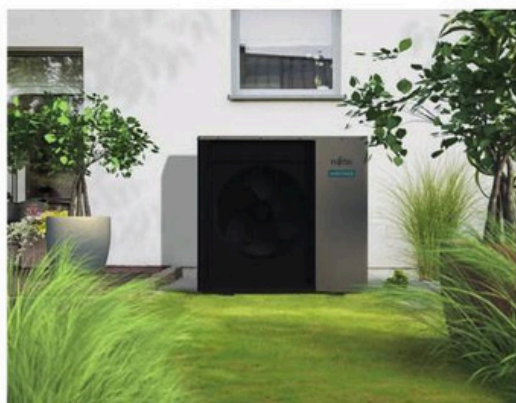
Venkovní jednotka tepelného čerpadla Monoblok Fujitsu AIRSTAGE, umístěná v zahradě rodinného domu. IMPROMAT KLIMA
