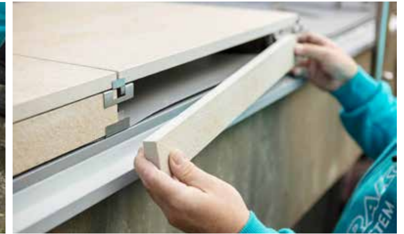
10 | Einbringen der Streifen in die Sockelclips Unter Zuhilfenahme von Sockelclips werden die Fliesenstreifen an der Balkon- oder Terrassenfront eingelegt.
