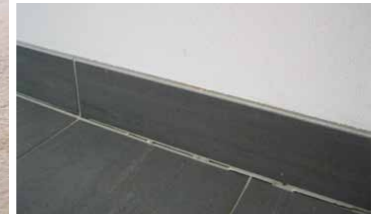
Bild 26 Gerissene Dehnungsfuge ohne Verwendung des Trennseils
