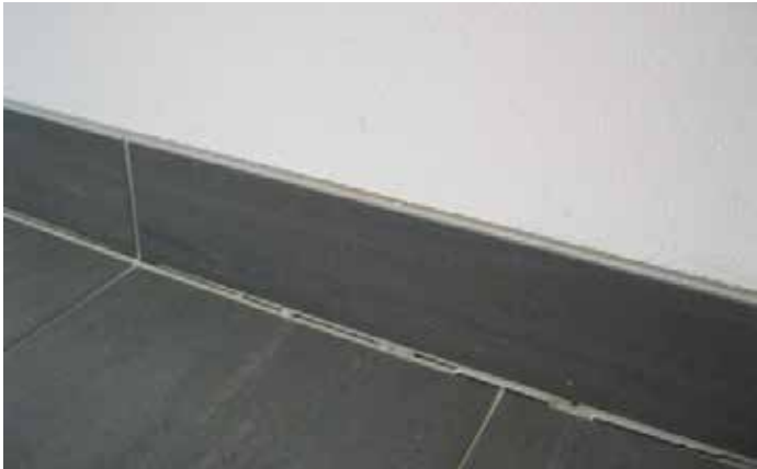
Obr. 23 – Potrhaná dilatační spára bez použití separačního provazce
